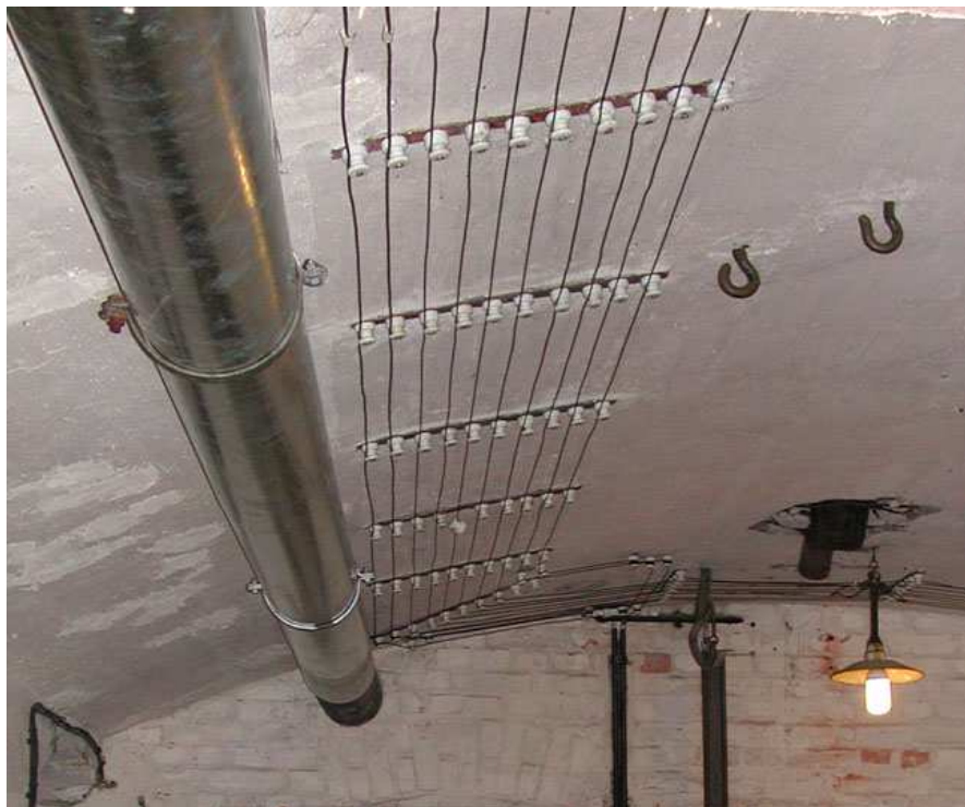
Mutzig, Infanterieraum n°1 (1899 – 1910) : Elektrische Leitungen und Belüftungsanlage
